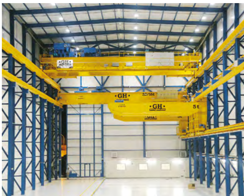
Grúa birrail y grúa ménsula
